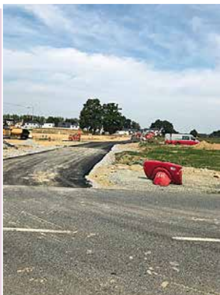
Travaux ZAC de la Plesse : les 31 lots de la tranche 3 sont viabilisés, 21 lots sont déjà réservés.
